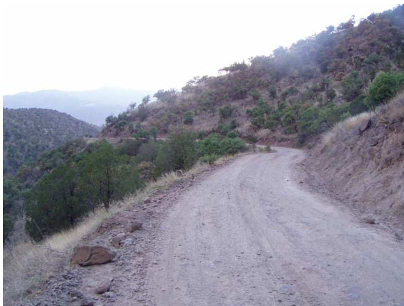
Foto II.2- Camino de acceso al sitio del proyecto Dolores (UTM 12R, X= 771,801 E, Y= 3,214,355 N). Mayo 2004.
