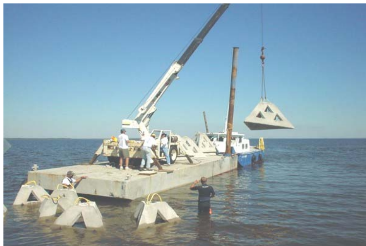
Figura 11. Vista de la chalana y de la grúa, que se utilizara para la colocación de las AMA 4 .
